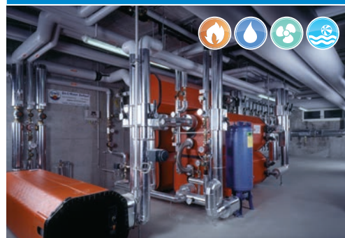
HEIZZENTRALE, KURKLINIK, BAD WIMPFEN
